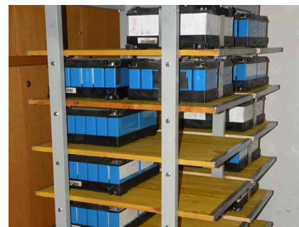
Abbildung 3: Lithium-Ionen-Batterie-module (Hochformat) und daneben werden.
