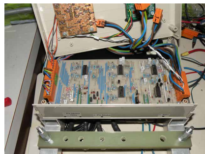
Abbildung 8: Photovoltaik-Laderegler und Balancer mit Schutz daneben
