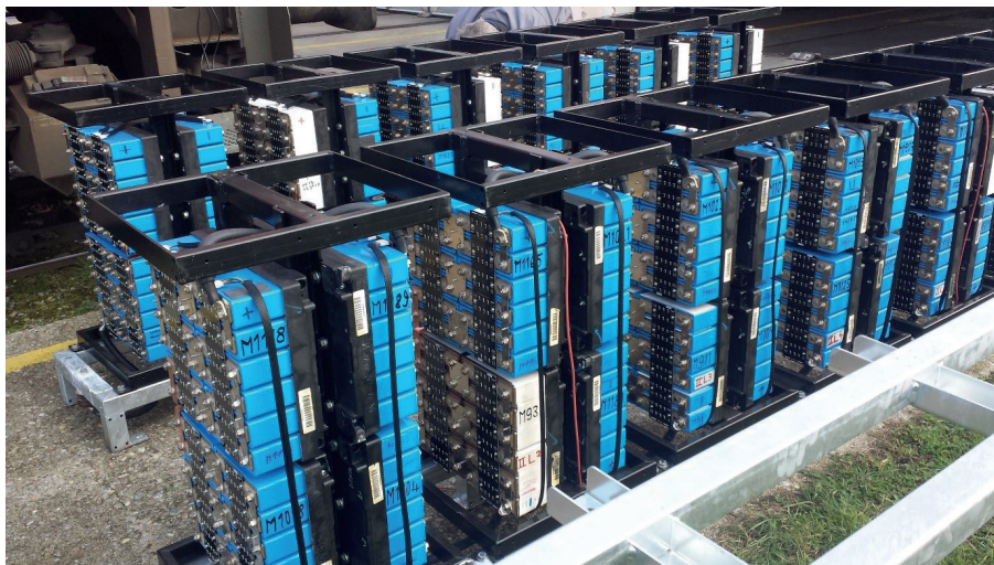
Abb. 2: Zwei der vier Teileinheiten der Fahrbatterie ohne Abdeckung und mit Monitoring-Platinen ausgerüstet
