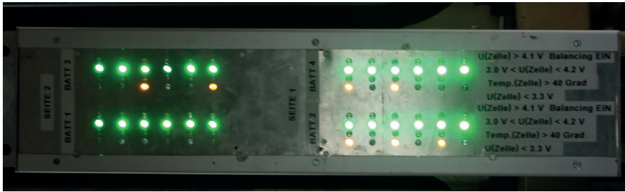
Abb. 4: Anzeigetafel zur Zustandsfeststellung der Teileinheiten der Fahratterie
